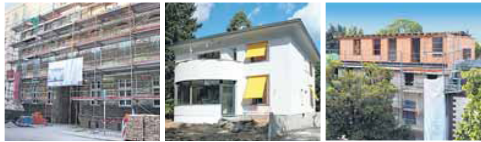
Energetisch saniert, am 10.10. zu besichtigen: Altbauten in Lichtenberg und Steglitz (l.u.r.), Haus in Spandau (M.).
